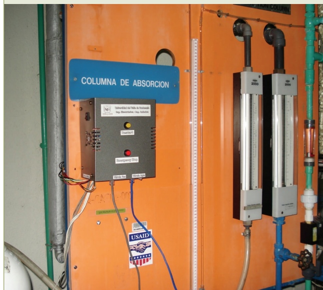
► Figura 7. Panel de control instalado
