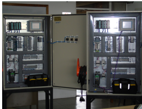
Figura 3: Fotografía de los tableros de control actuales
