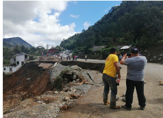
Figura 8: Ejemplo de un derrumbe de traslación en Baja Verapaz, Guatemala
