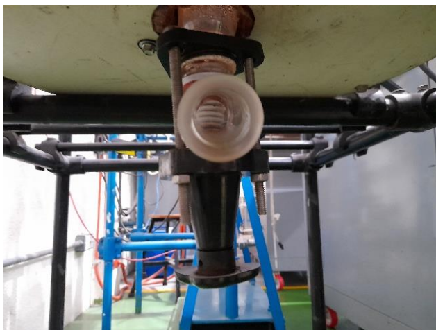
Figura 11. Válvula de purga del residuo.
