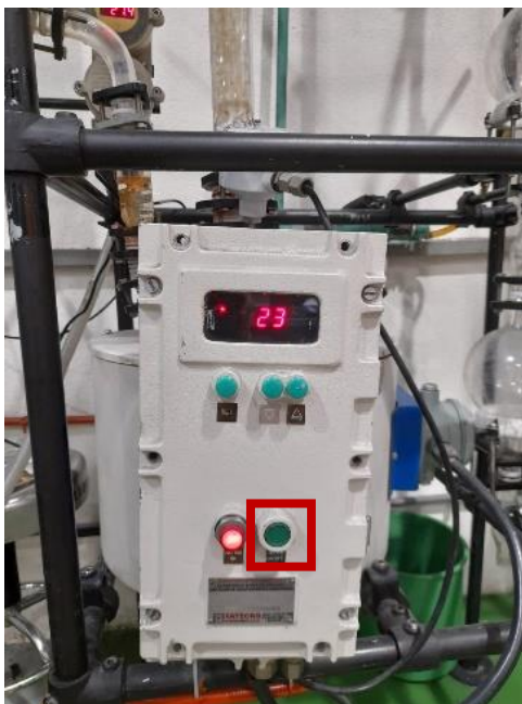
Figura 9. Panel del controlador de temperatura (botón “Heater ON/OFF”).
