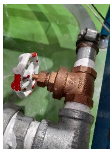
Figura 4. Válvula que lleva el agua de enfriamiento al desagüe.
