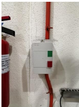
Figura 6. Interruptor del controlador de temperatura.
