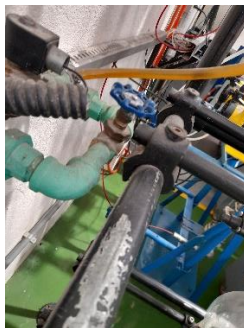
Figura 5. Válvula de suministro de agua.
