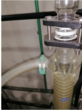
Figura 23. Conexión de manguera con intercambiador de calor.
