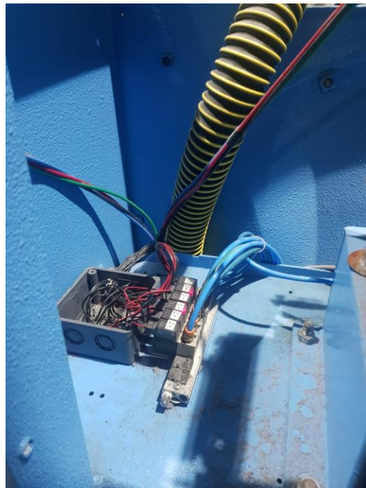
Figura 39: Manifold y electroválvulas de 24 vdc
