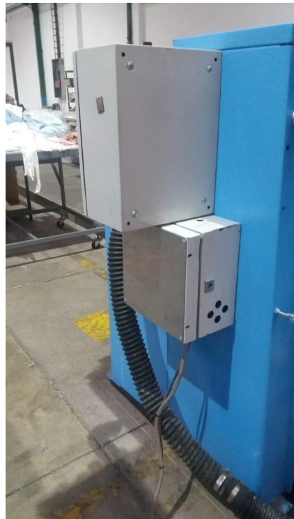
Figura 72: Panel de control lavadora provisional
