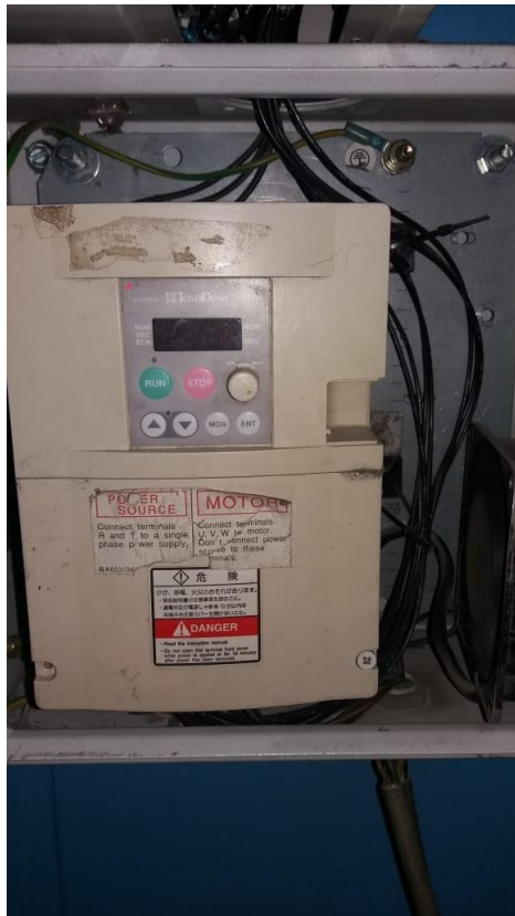
Figura 74: Panel de control lavadora provisional
