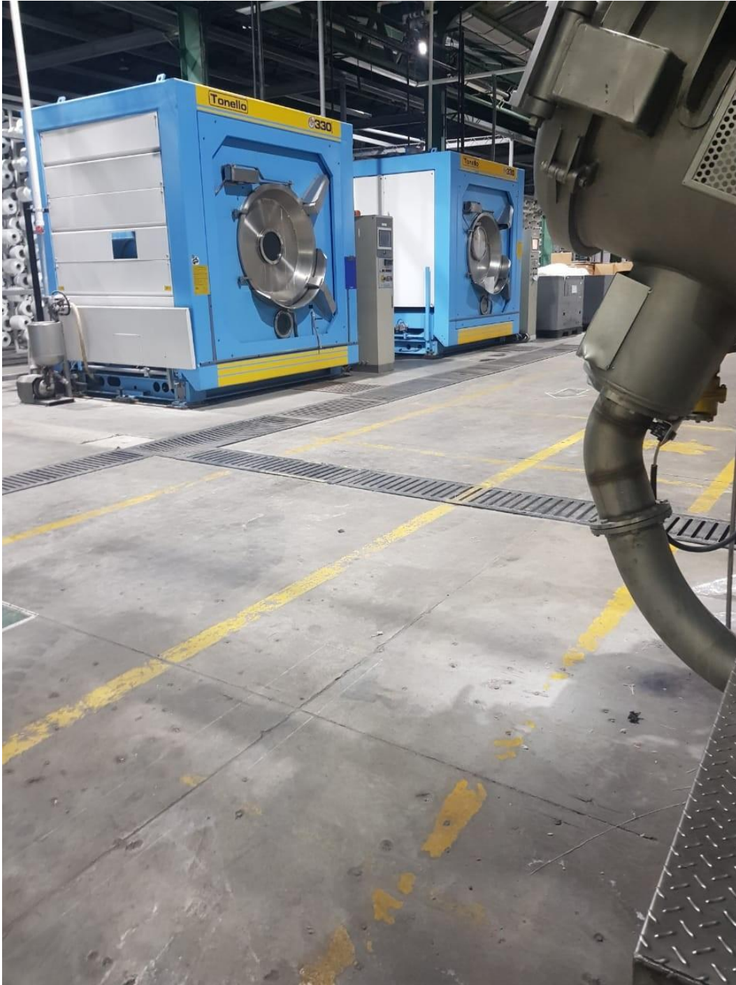
Figura 2: Lavadoras 4 y 5, Área de tintorería
