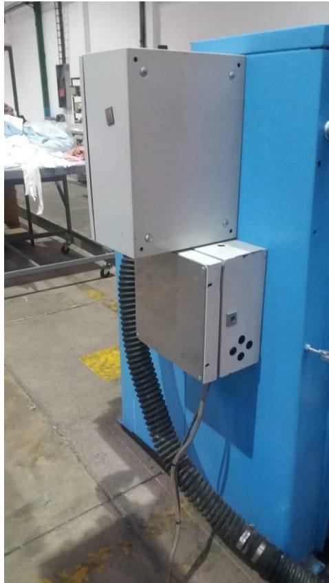
Figura 71: Instalación de tablero secundario, lavadora provisional
