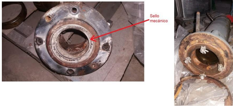
Figura 12: Sello mecánico antes de cambiarlo
