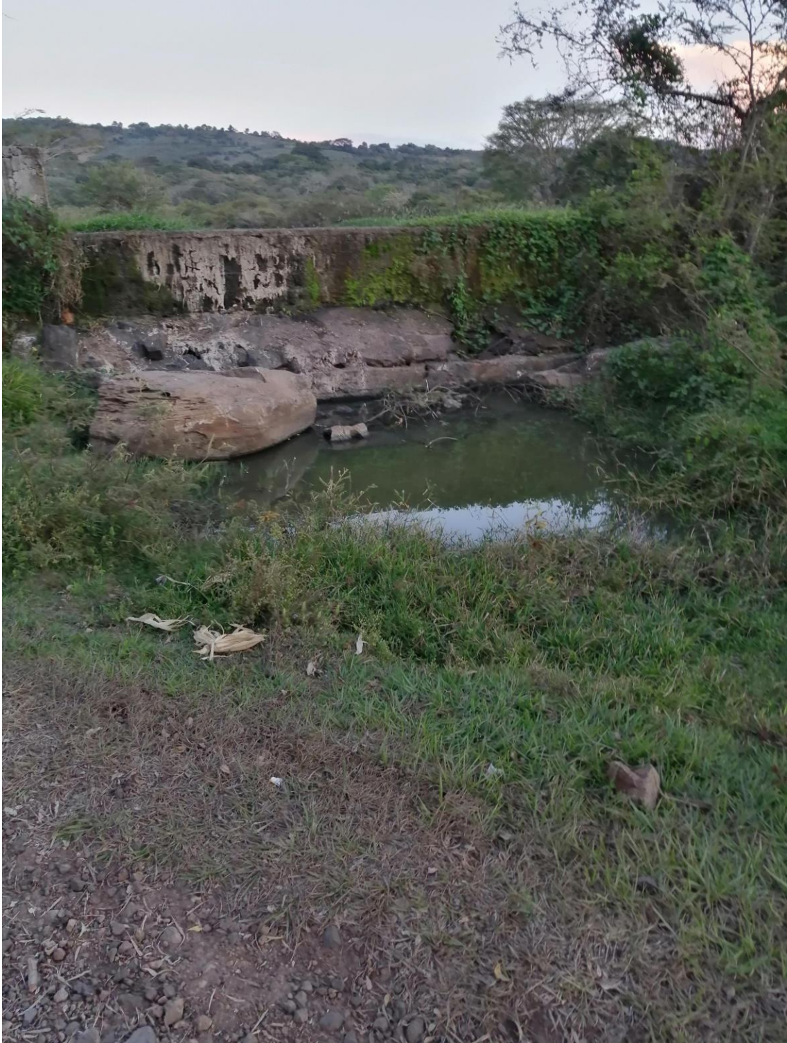
Figura 54. Anexo 3 - Ejemplo de laguna artesanal para captar el agua de lluvia
