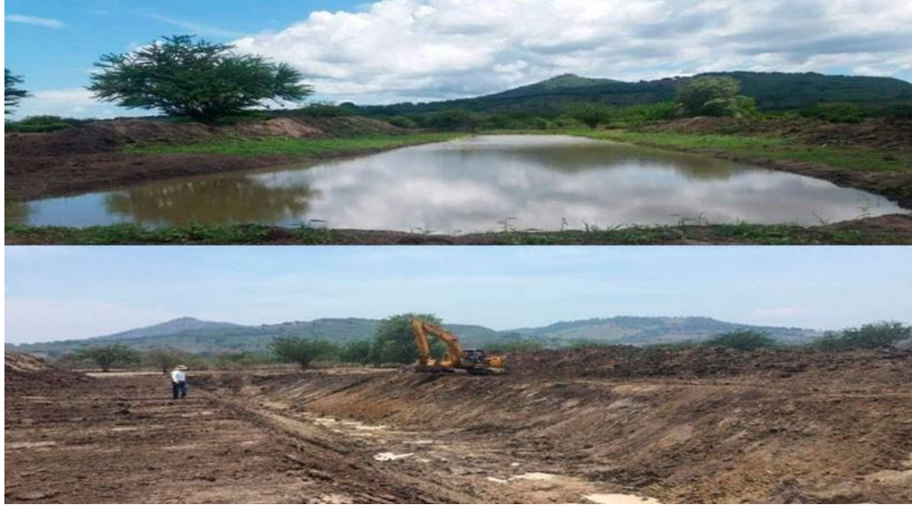
Figura 25. Reservorios en aldea el Tempisque, Agua Blanca, Jutiapa. (FAO, 2019)
