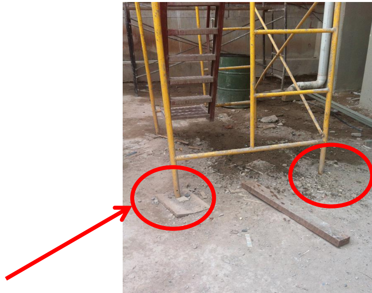
Ilustración #51: Modo incorrecto de nivelar andamios.
