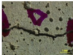
Figura 259: Grieta A del cubo 1 cepa P.5.2.A sin medio de precipitación
