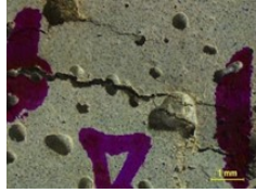
Figura 277: Grieta A del cubo 3 cepa P.5.2.A sin medio de precipitación
