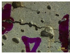
Figura 250: Grieta A del cubo 3 cepa P.4.1.A sin medio de precipitación
