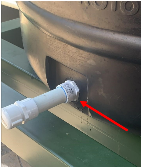
Figura 46: Fuga de agua en la salida del depósito
