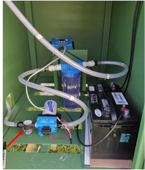
Figura 47: Fuga de agua en las conexiones del filtro de agua de la bomba
