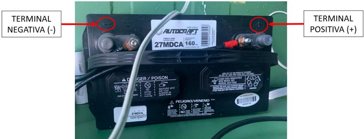
Figura #6: Terminales en la batería de 12V
