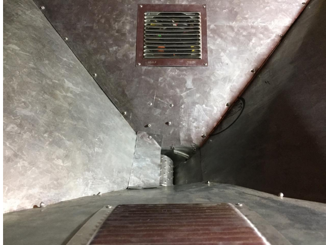
Figura 5.9: Interior del silo, ventilas que permiten a los ventiladores realizar su trabajo sin interrumpir la función piramidal del silo.
