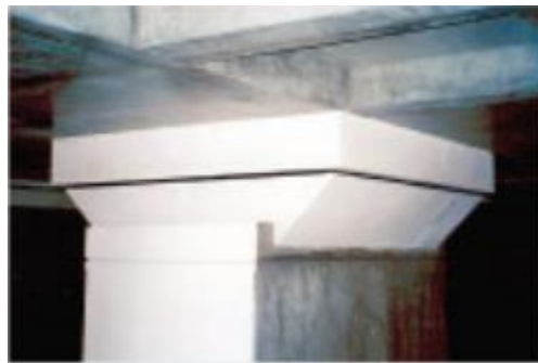
Figura No. 47 Aislador con caja protectora al fuego
