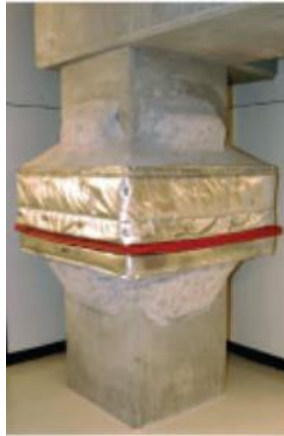
Figura No. 46 Aislador con manta ignífuga
