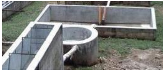
Figura 79. Tanque homogeneizador de caudal
