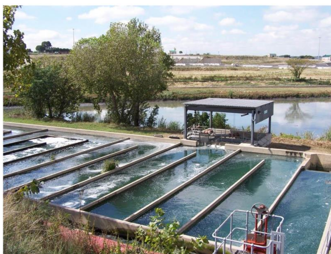
Figura 89. Tanque de contacto
