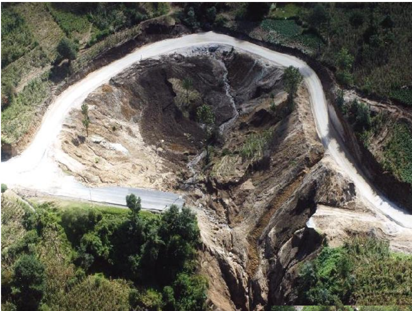
FOTOGRAFÍAS No.47: Km 156 CA-01 Occidente
