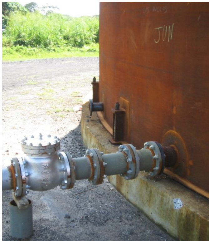
Figura No. 7: Vista de anclajes y una conexión de tubería
