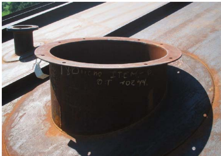
Figura No. 4: Paso de hombre de techo
