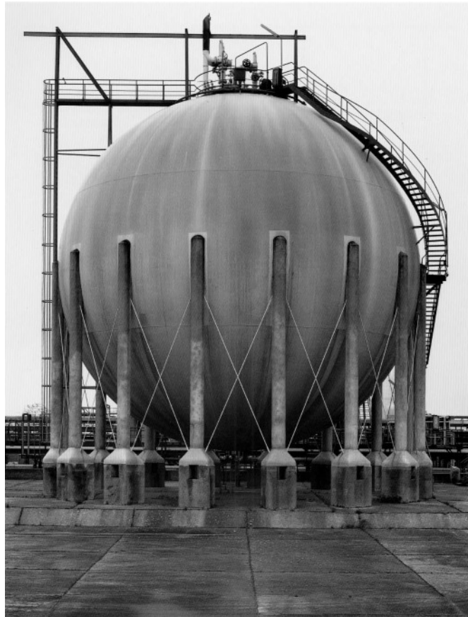
Figura No. 11: Tanque esférico de almacenamiento de gases
