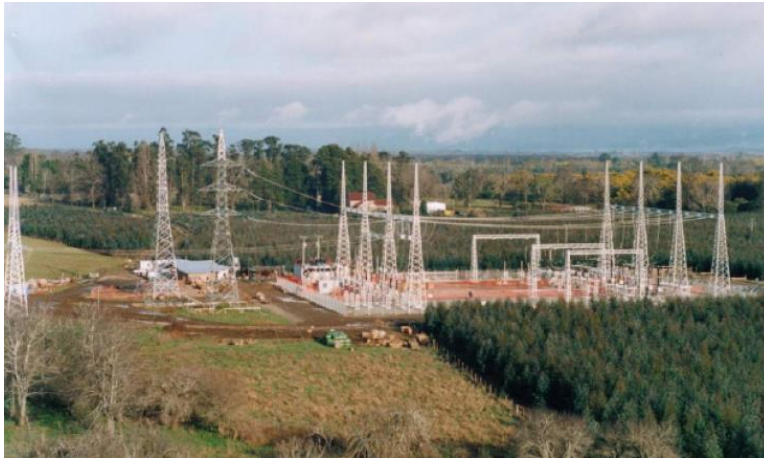
Ilustración 5. Subestación de maniobras Ciruelos, Chile. Línea de 220 kV.
