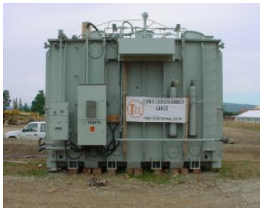
Ilustración 6. Transformador de poder.
