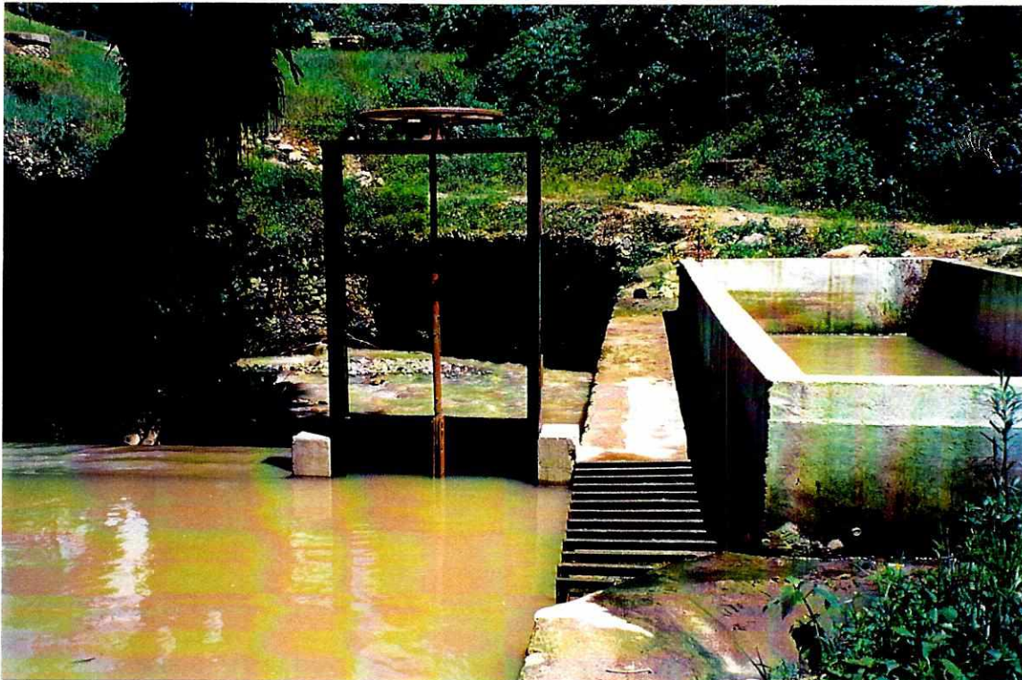
En la imagen: Tanque desarenador, reja de metal y compuerta.
