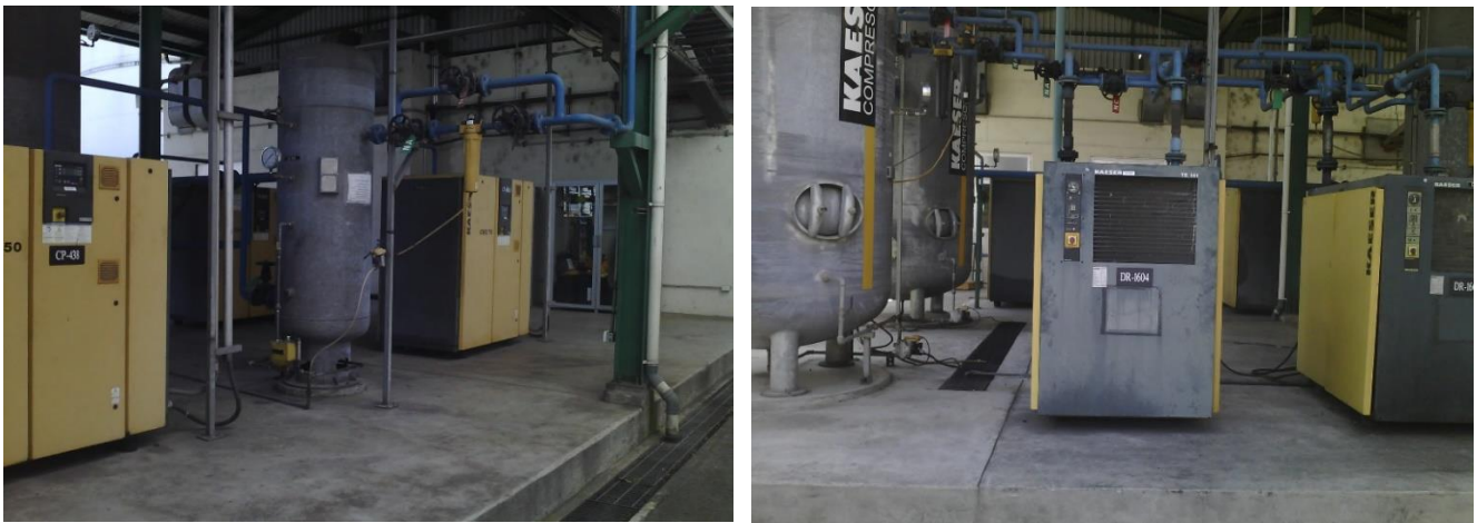
Figura 1. Sala de compresores de la planta.
