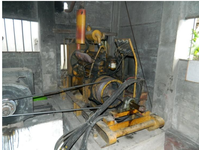
Figura 44. Planta auxiliar de generación eléctrica de finca La Fama.
