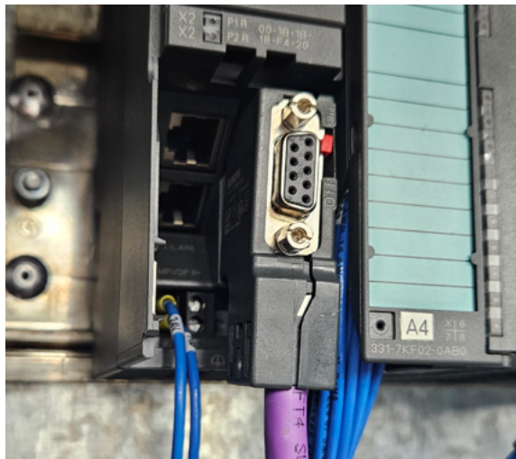
Figura 11: Puerto PROFIBUS-DP en el PLC
