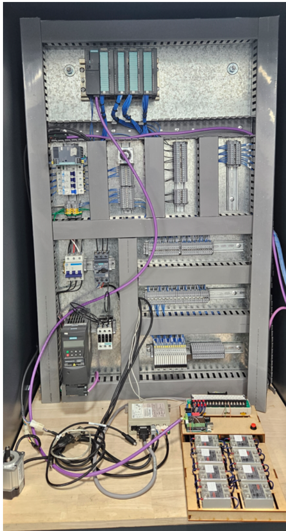
Figura 37: Prototipo en el tablero del laboratorio de automatización
