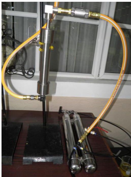
Figura No. 51: Deshumidificador y tanques de almacenamiento de hidruro metálico \text{LaNi}_5
