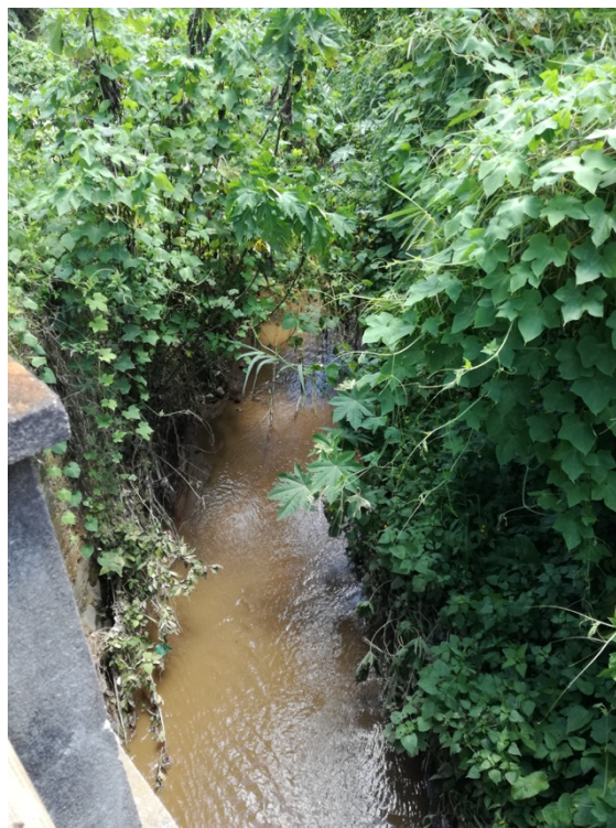
Imagen 18: Cauce del río Pensativo con obstrucción vegetativa
