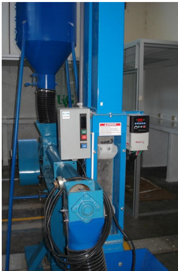
Ilustración 19. Variador instalado en el elevador de cangilones
