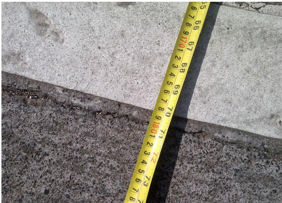
Ilustración 63: Deformación de losa corta de 27 cm
