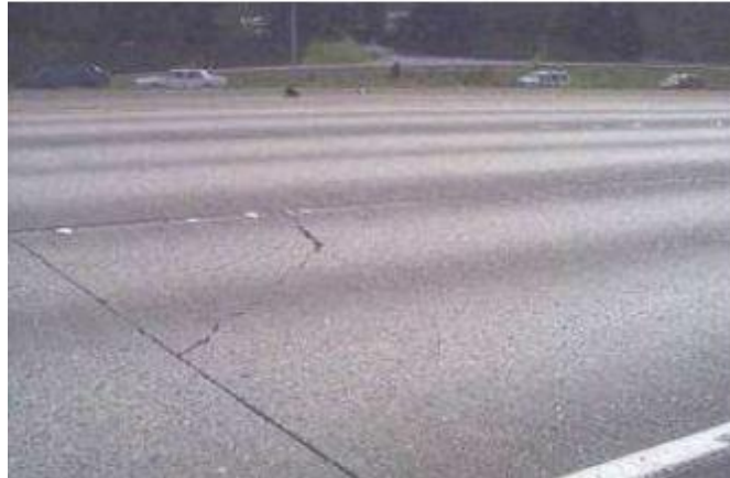
Ilustración 9: Grietas de esquina
