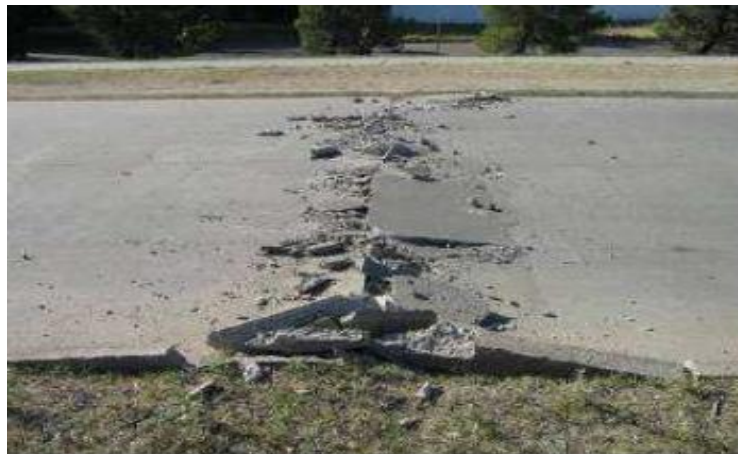
Ilustración 10: Grietas de voladura
