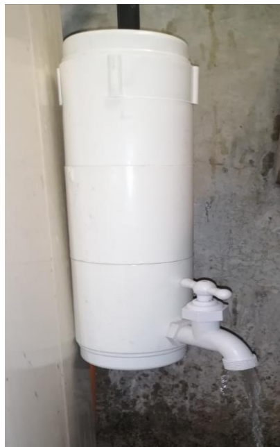
Figura No. 6 Etapa de filtración
