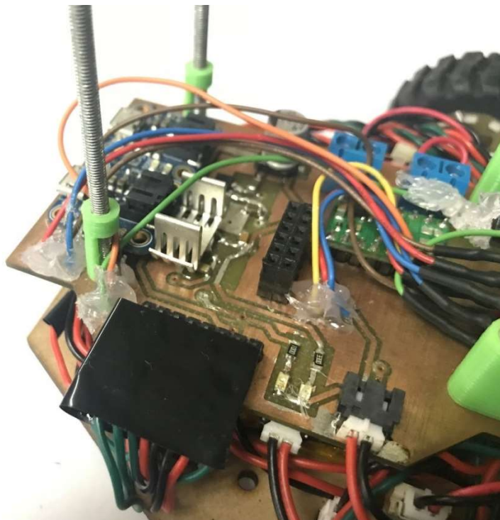
Figura 253. Disipador colocado sobre regulador de 5V.
