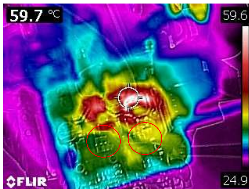
Figura 260. Disipadores nuevos con carga alta.
