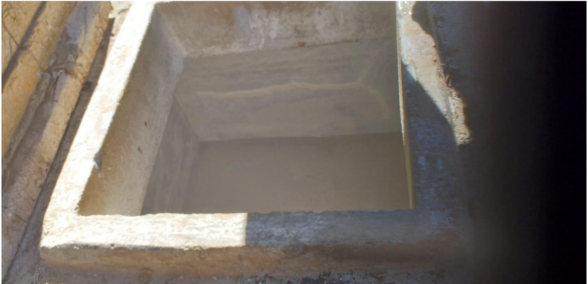
Ilustración 11. Tanque de cloración sistema No. 1
