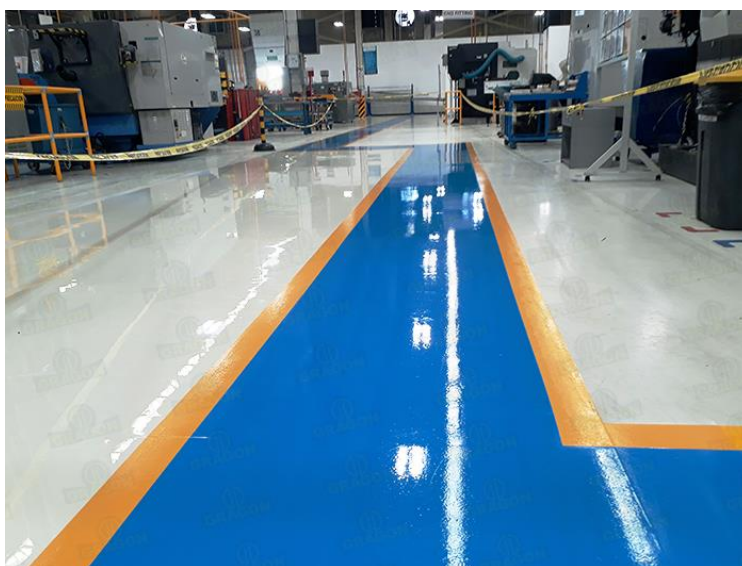
Figura 28: Piso epóxico para planta
