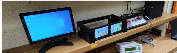
Figura 6.7: Sistema controlador para irradiador G - 100
