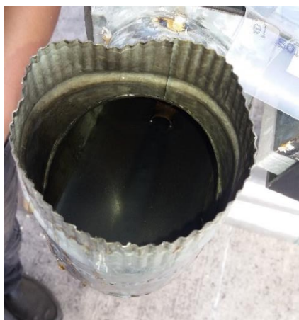
Ilustración 32. Condensado dentro del intercambiador de calor
