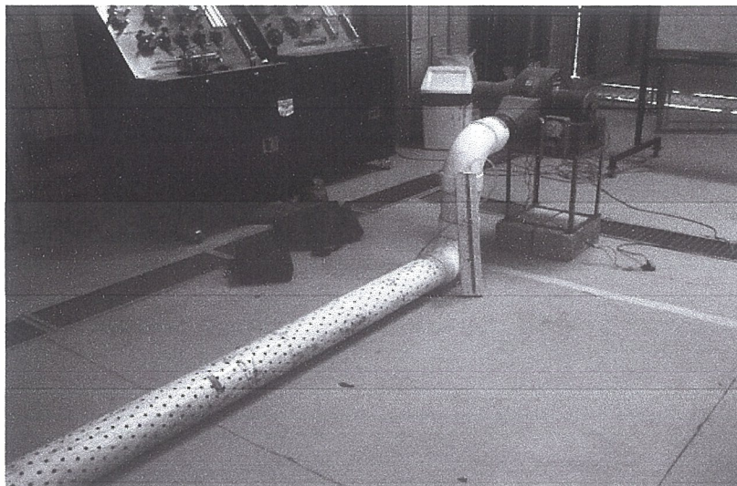
Ilustración 30, Sistema de ventilación
