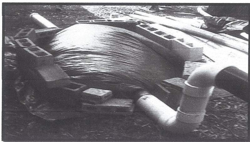
Ilustración 41, Biodigestor operando, etapa # 2
