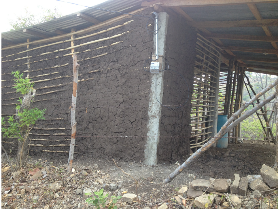
Imagen 8 Ejemplo de las grietas de una casa de bajareque en construcción
