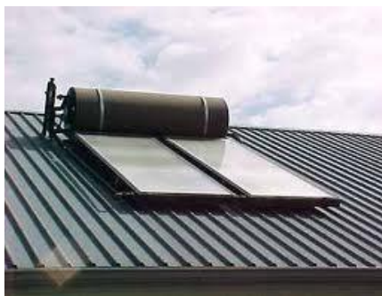
Ilustración 138: Sistema solar de calefacción de agua.
