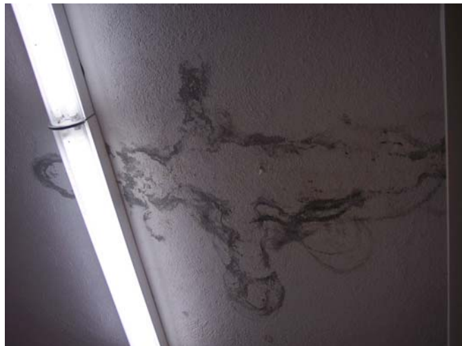
Daños en losas por empozamientos
