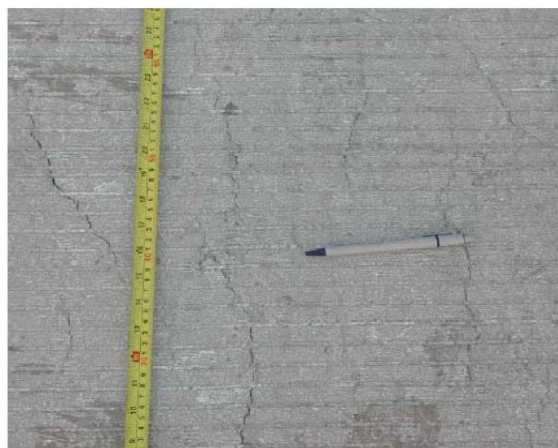
Figura 1.2 Grietas en losa de concreto reforzado
