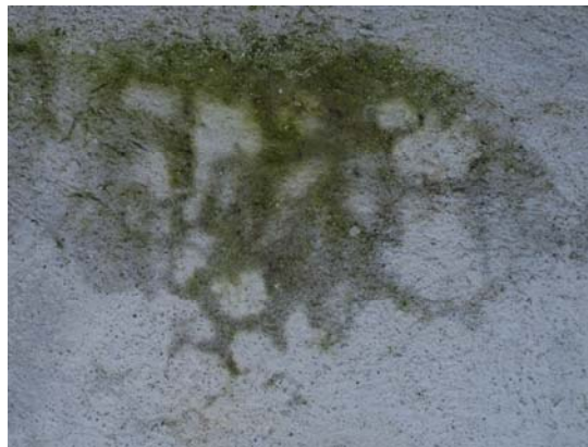
Figura 5.4 Humedad en losas
