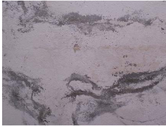
Figura 5.2 Goteras en losas
