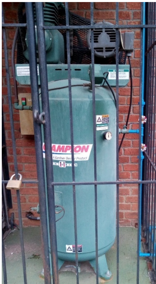
Ilustración 75: Vista frontal del tanque de almacenamiento de aire comprimido
