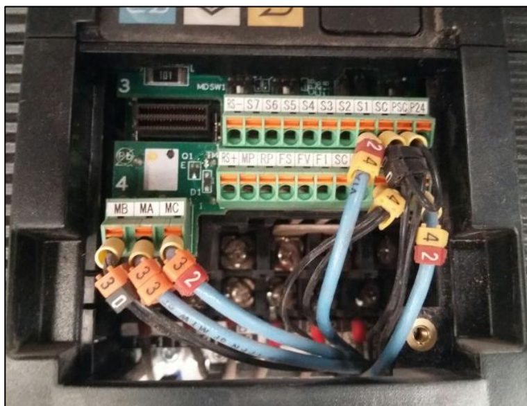
Figura 30. Interconexiones de los variadores de frecuencia utilizados.
