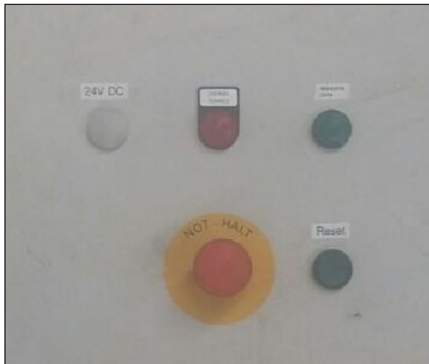
Figura 33. Implementación botonera tablero
