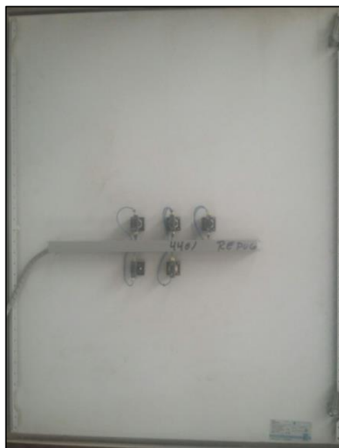
Figura 34. Conexión de la botonera del tablero por la parte de atrás.
