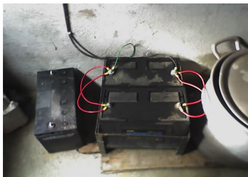
Fig. 3.3 Banco de baterías del sistema
