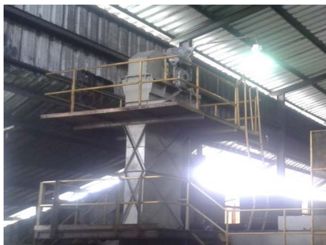
Ilustración No. 15 Fuerza motriz de elevador de azúcar
