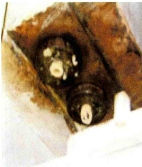
Fotografía No. 6 Detalle de las salidas del extrusor que habrán que modificar
