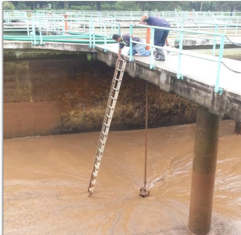
Figura No. 19. Uso inadecuado de escalera
