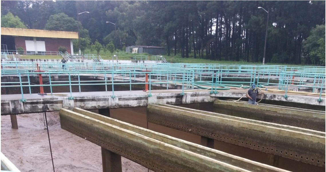
Figura No. 15. Peligro de tanques sin barandillas
