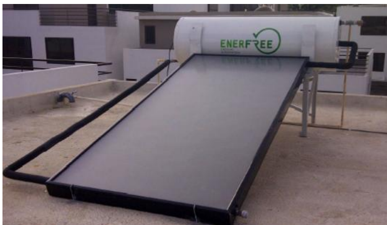
Ilustración No. 61: Calentador de agua solar de placa plana de 150 galones.
