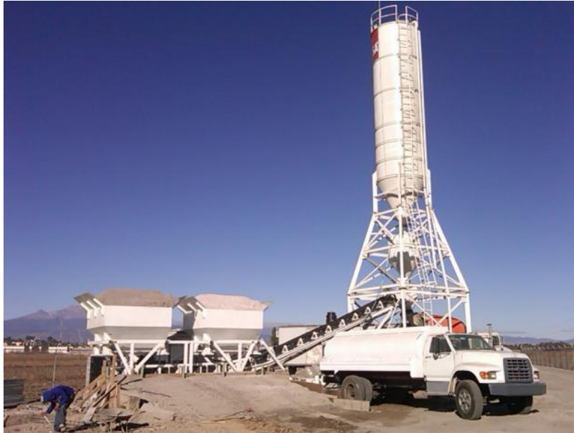
Ilustración No. 19: Dosificadora de agregados.
