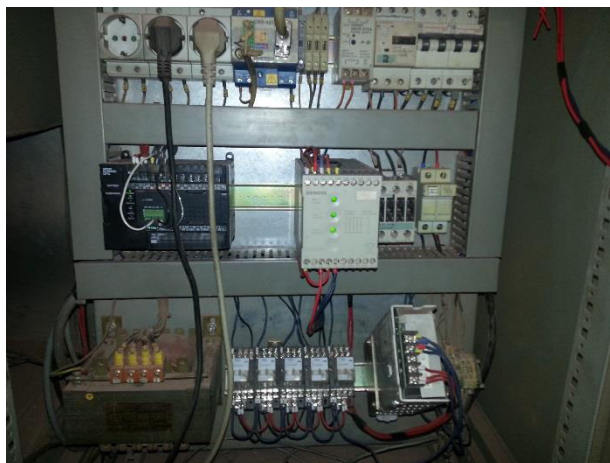
Imagen 20: Panel central con automatización 32
