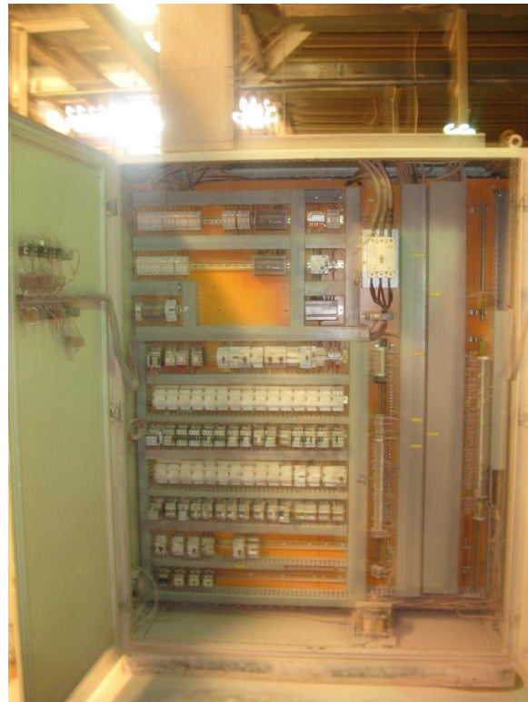
Imagen 19: Panel central previo a automatización 32
