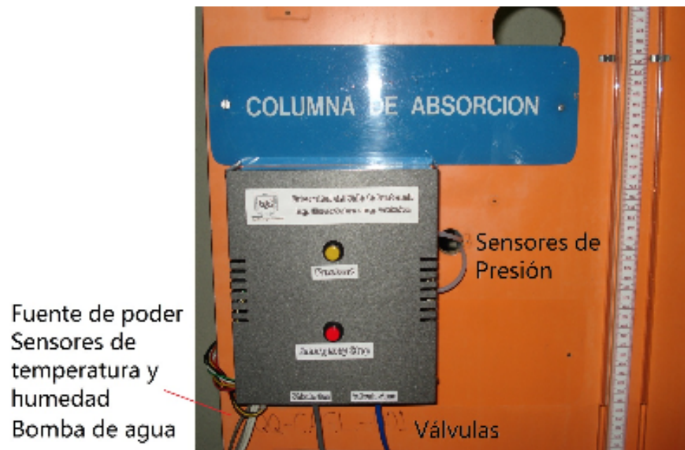
Figura No. 118 Entradas en el panel de control
