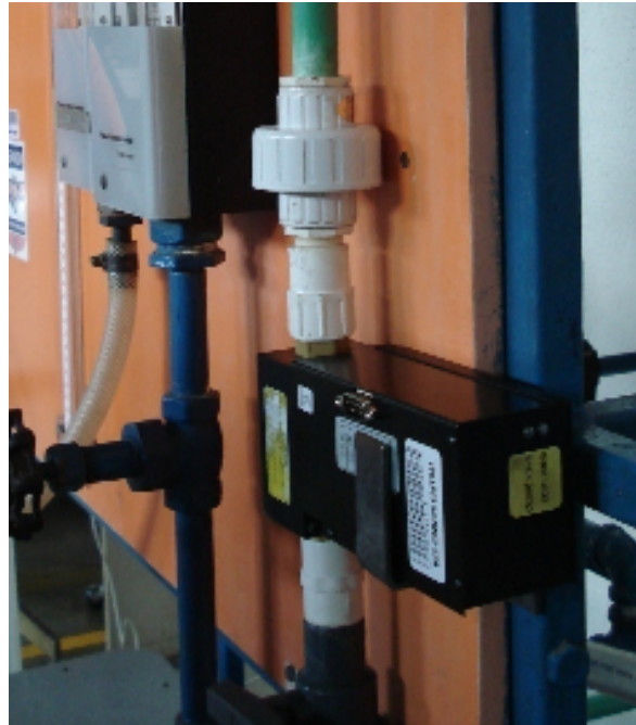
Figura No. 112 Válvula para el control del flujo de agua
