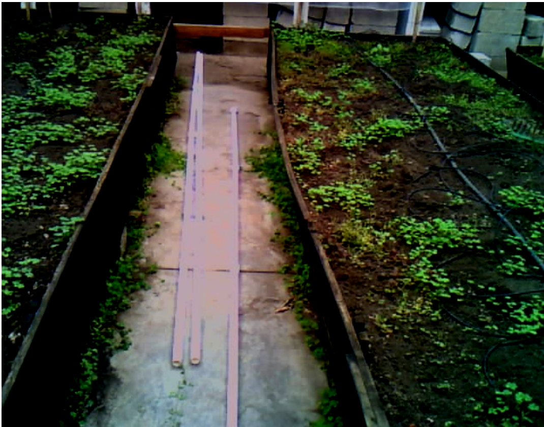
Figura No. 35: Tubería de ramas auxiliares
