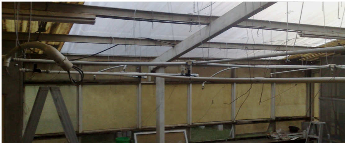
Figura No. 37: Rama principal elevada junto a la tubería de la estructura de cableado de la red de sensores
