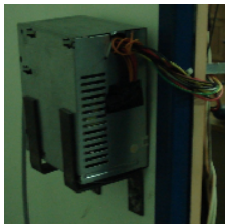
Figura No. 116 Fuente de poder instalada
