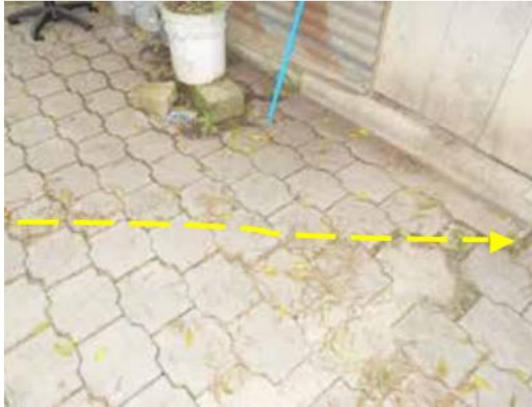
Figura 2 Daños provocados por el deslizamiento del Cambray II
