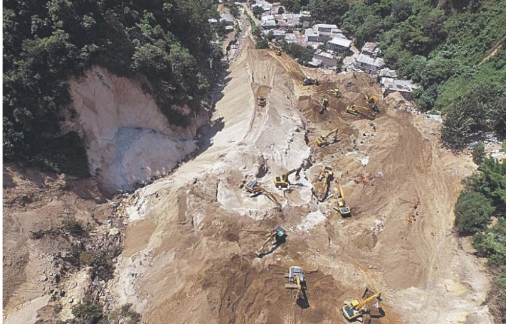
Figura 14 Deslizamiento de talud en Cambray II, Guatemala
