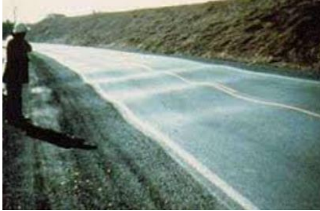
Figura 26: Corrugación causada por la acción de tránsito combinada con una carpeta o base inestable (Gabela, 2013)
