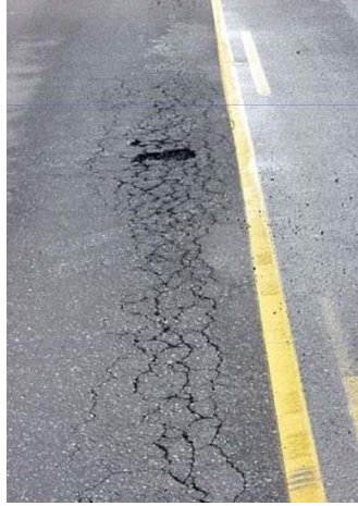
Figura 28: Piel de cocodrilo causada por las cargas repetidas de tránsito (Corredor, 2010)
