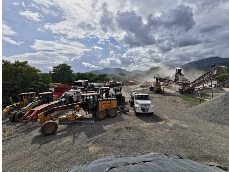
Figura 40: Planta proveedora de agregado
