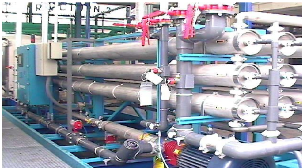
Ilustración No 18: Housing de la ósmosis inversa
