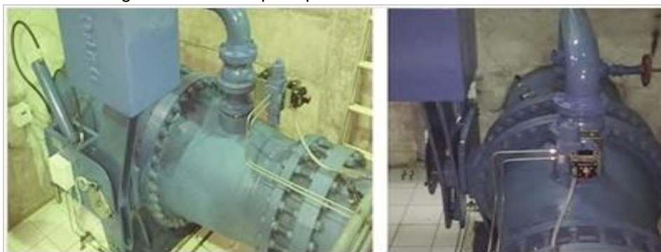
Figura 10. Válvula principal de entrada instalada.
