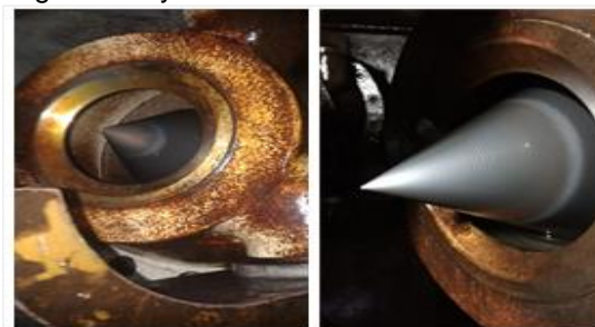
Figura 4. Inyector de la turbina Pelton instalada.
