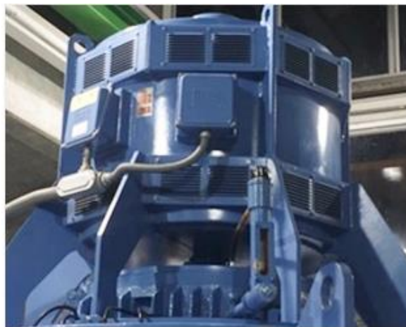
Figura 15. Excitatriz del generador instalado.
