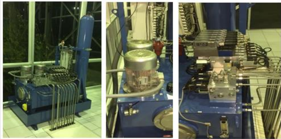
Figura 8. Unidad de presión hidráulica instalada.
