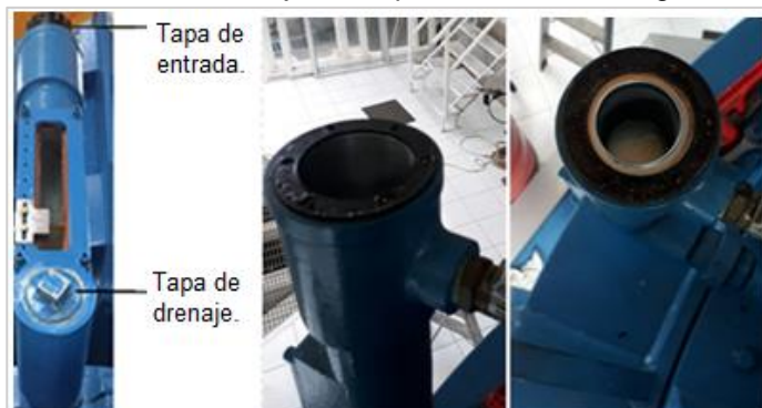
Figura 34. Lubricación de cojinete superior de aceite del generador síncrono.
