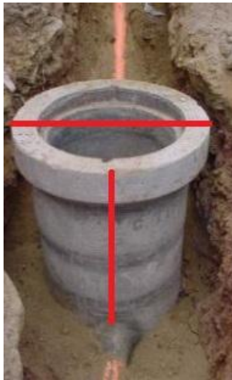
FOTOGRAFÍA 3. CAJAS DE REGISTRO
