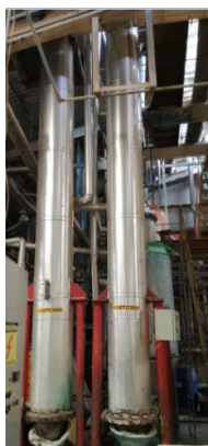
Ilustración 34, Intercambiador de calor
