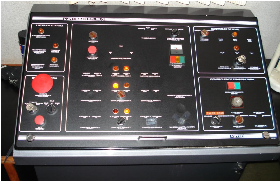
Ilustración 31. Consola para control del silo.
