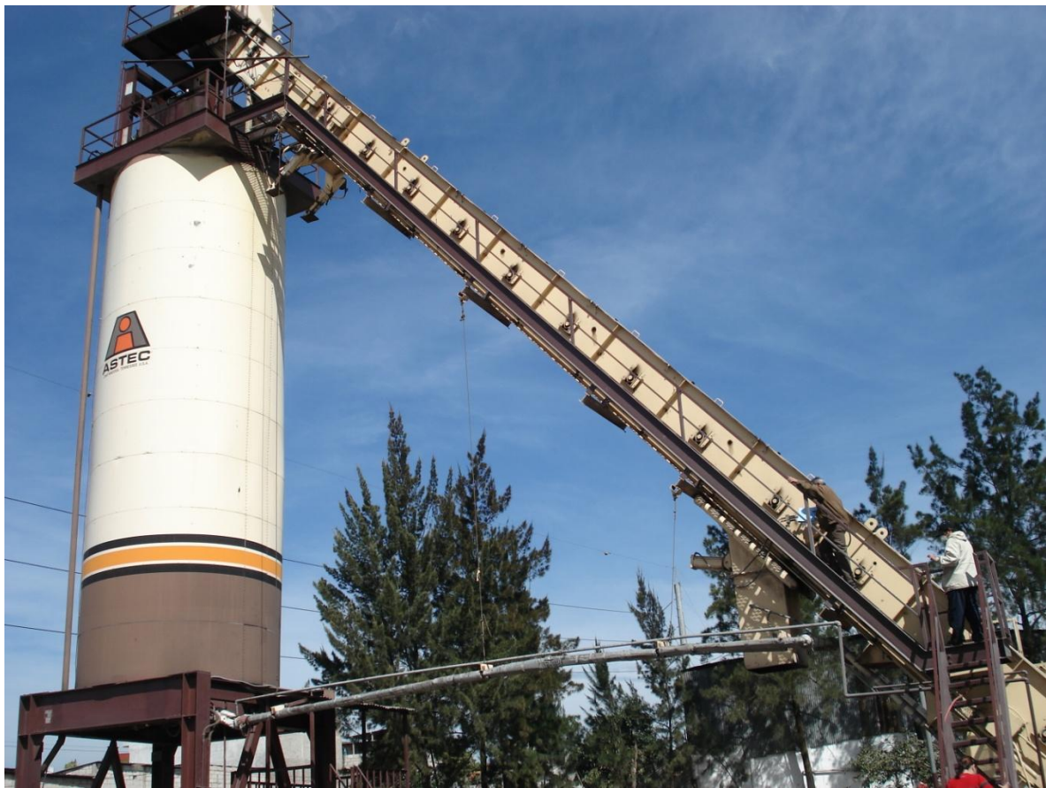
Ilustración 29. Banda transportadora de láminas de arrastre. Planta de Padegua, S.A.
