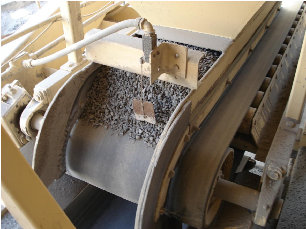
Ilustración 6. Banda de alimentación y compuerta de la tolva.
