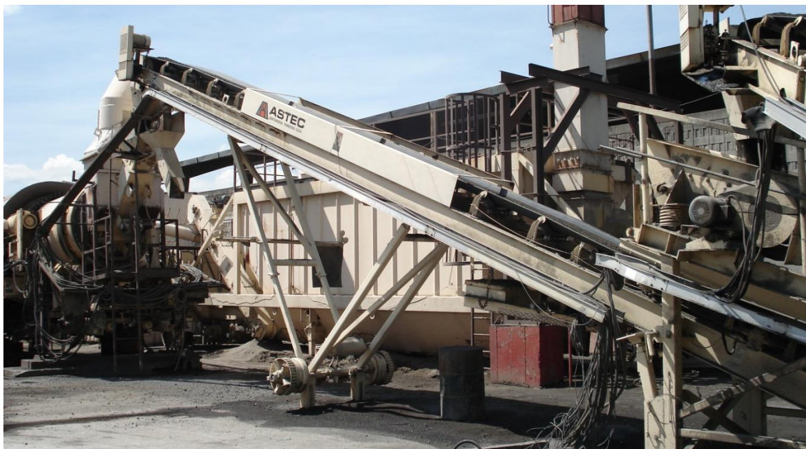
Ilustración 27. Banda de carga. Planta de Asfalgua, S.A.
