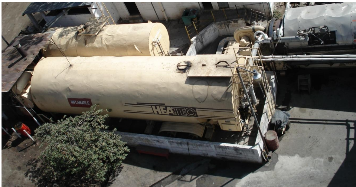
Ilustración 9. Tanque de almacenamiento de cemento asfáltico. Planta de Padegua, S.A.
