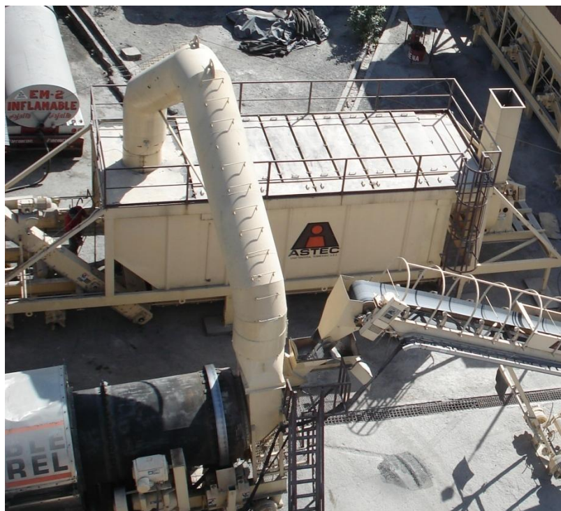
Ilustración 35. Cámara de filtros, vista exterior.
