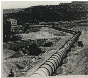
Figura No. 26 Tubería aérea
